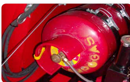
Impianto GPL LPG system instalación
